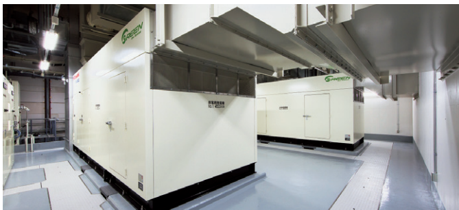
非常発電機（MDA-DC 専用）
