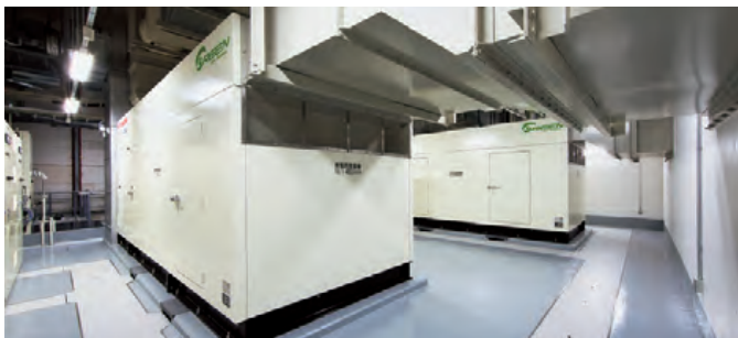
非常発電機（MDA-DC 専用）
